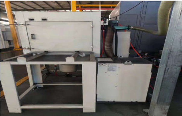
喷砂工段自带除尘器
